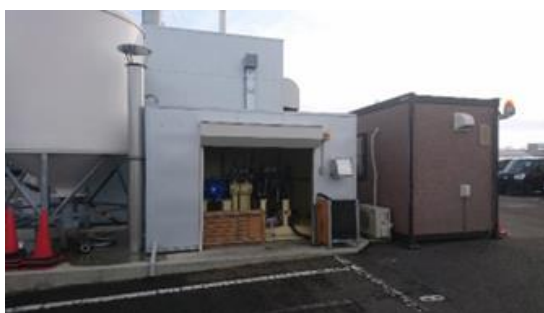
福島で実施された除染後の森林樹木から発電する施設
